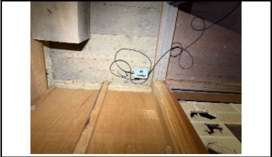
建物地震計設置写真
