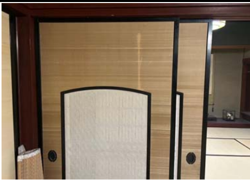
写真番号 1 調査場所 ①和室 8 畳 状況メモ 襖 汚れ
