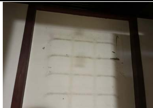
写真番号 4 調査場所 ①和室 8 畳 状況メモ 仏間 白壁汚濁
