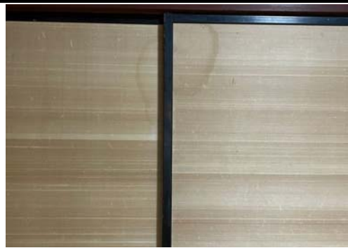
写真番号 2 調査場所 ①和室 8 畳 状況メモ 襖 汚れ
