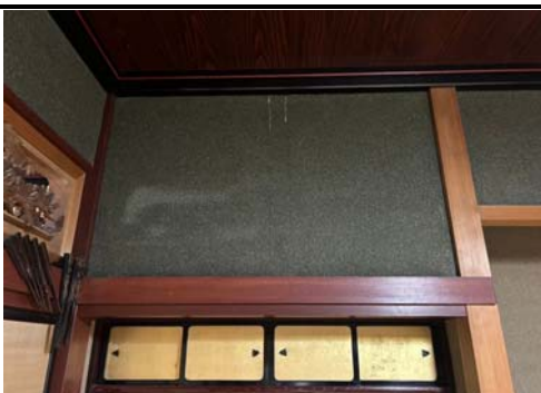
写真番号 5 調査場所 ②和室 8 畳 状況メモ 壁 汚濁
