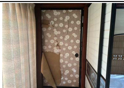
写真番号 6 調査場所 縁側 状況メモ 襖戸 破損
