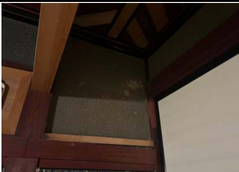
写真番号 3 調査場所 ①和室 8 畳 状況メモ 壁 汚濁
